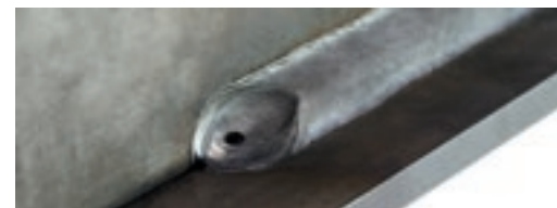
Sans remplissage de cratère final.
